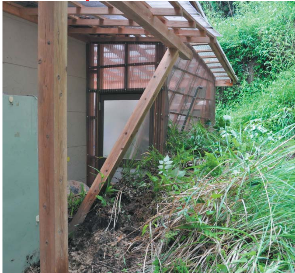
[6.19]大雨による土砂崩れが家屋にせまる
