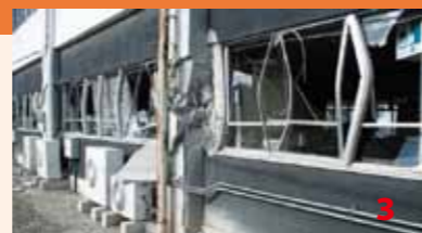
3 倒壊の危険性が高まる市役所
