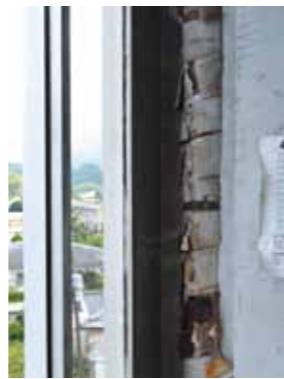
配管がむき出しに
