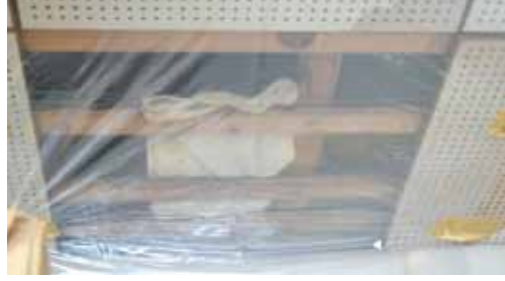
雨漏りしている天井
