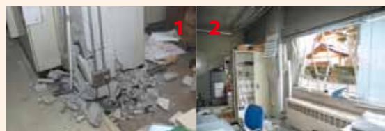
1 本庁舎中央館南側の柱が大きく破損 2 窓枠がつぶれ、ガラスが散乱した事務室
