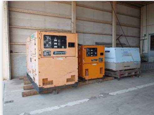
野尻庁舎 非常用発電設備（可搬式）
