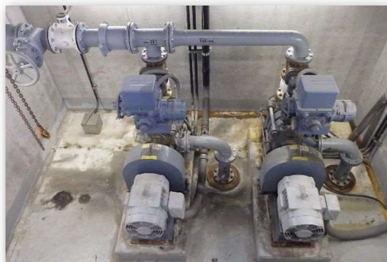
妙見水源地（送水ポンプ）
