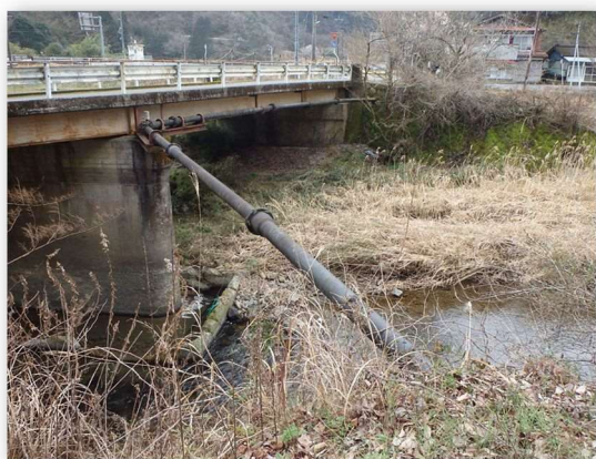
老朽化した配水管
