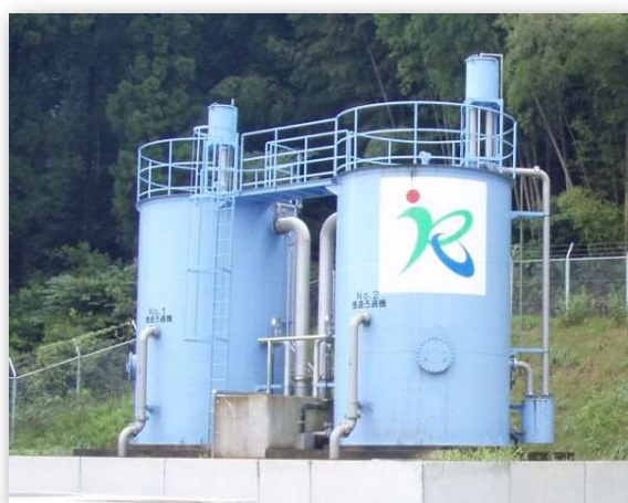
鬼塚浄水場（急速ろ過機）
