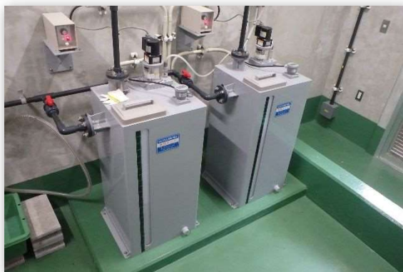
平ノ前浄水場（消毒機器）
