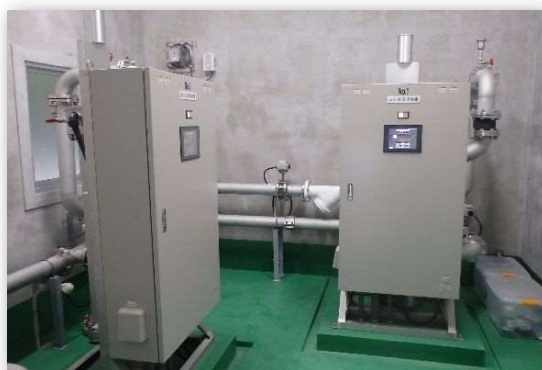
小丸浄水場（紫外線処理装置）
