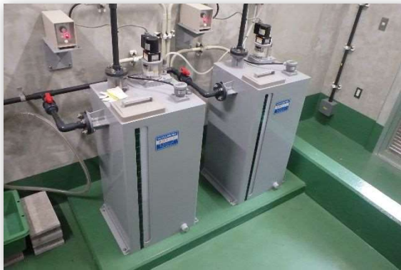
平ノ前浄水場（消毒機器）
