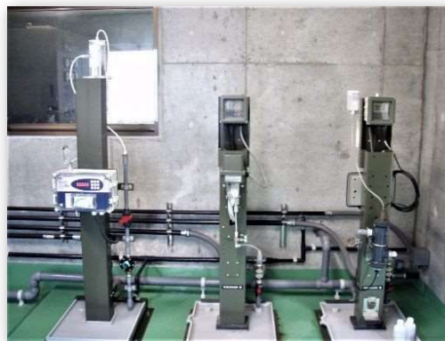
西部浄水場（水質計測機器）
