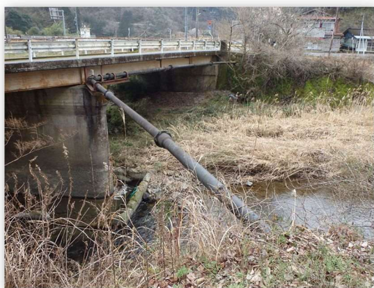
老朽化した配水管
