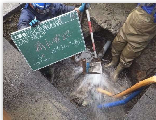
老朽化した配水管から突発的に発生する漏水
