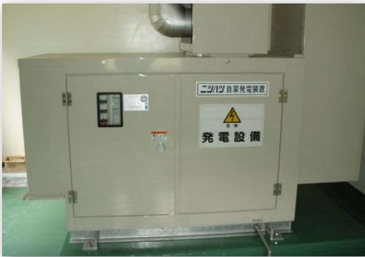
南部導水ポンプ場 非常用発電設備（常設）
