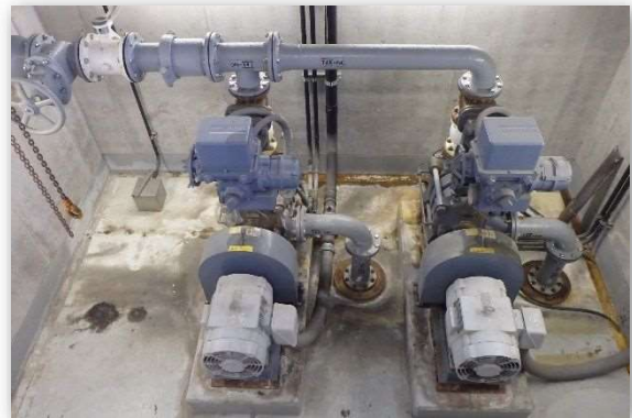
妙見水源地（送水ポンプ）
