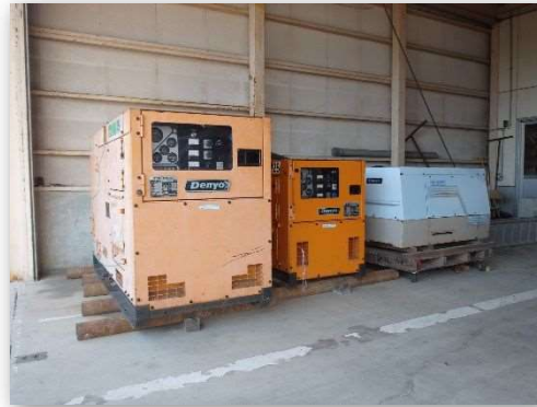
野尻庁舎 非常用発電設備（可搬式）
