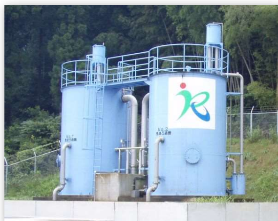
鬼塚浄水場（急速ろ過機）
