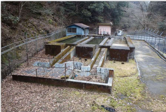
維持管理に苦慮する鳥田町浄水場（緩速ろ過池）
