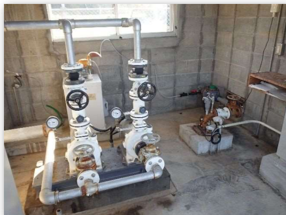
設備の老朽化が進む境別府水源
