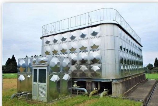
耐震対応の紙屋配水池
