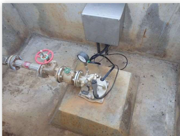
水質により機器故障が頻発する大王水源
