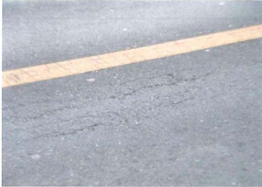
写真 2-1 舗装のひび割れ
