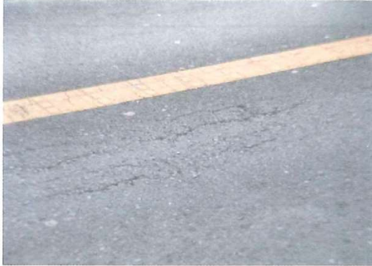
写真 2-1 舗装のひび割れ
