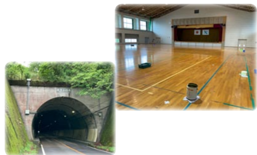
新軍谷トンネル・公共施設の雨漏り
