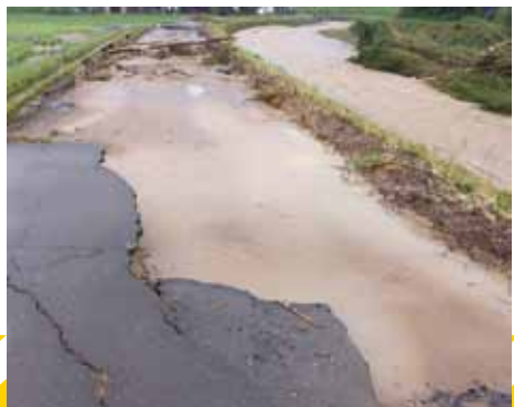
▼真方川の越水でアスファルトがはがれた隣接する道路
