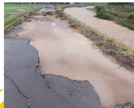
▼真方川の越水でアスファルトがはがれた隣接する道路
