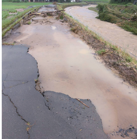
真方川の越水でアスファルトがはがれた道路
