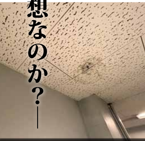
老朽化が進む公共施設 (写真は勤労青少年ホーム)
